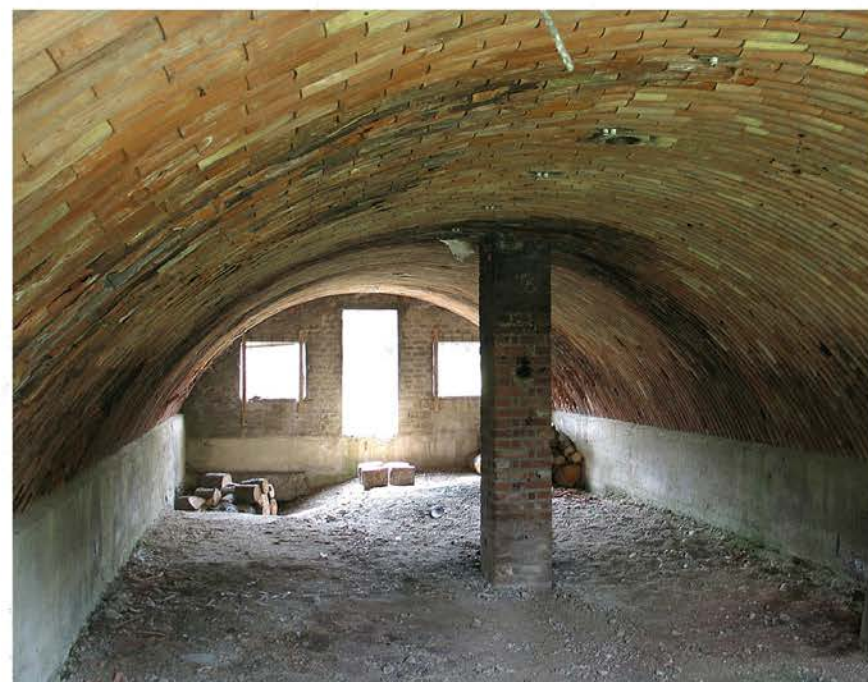
Die Tonröhren-Bauwerke in Kaufering VII sind akut vom Verfall bedroht. Bisher gab es nur eine Notsicherung. Fotos: Deiler
