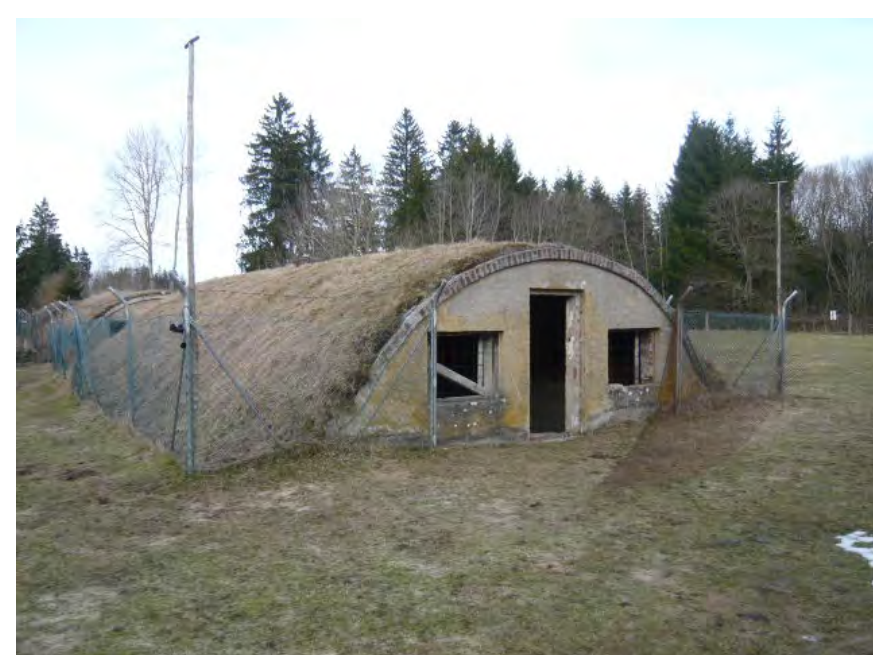
Tonröhrenbauwerk 3 vor der Instandsetzung Abb. 02 Fotoansicht 10.02.2011 von außen
