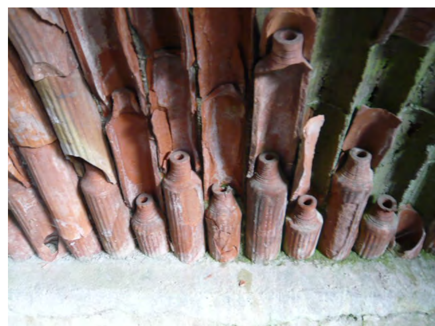
Schadhafte Tonröhren im Bauwerk 3 vor der Instandsetzung Abb. 06 Detailansicht 10.02.2011 innen
